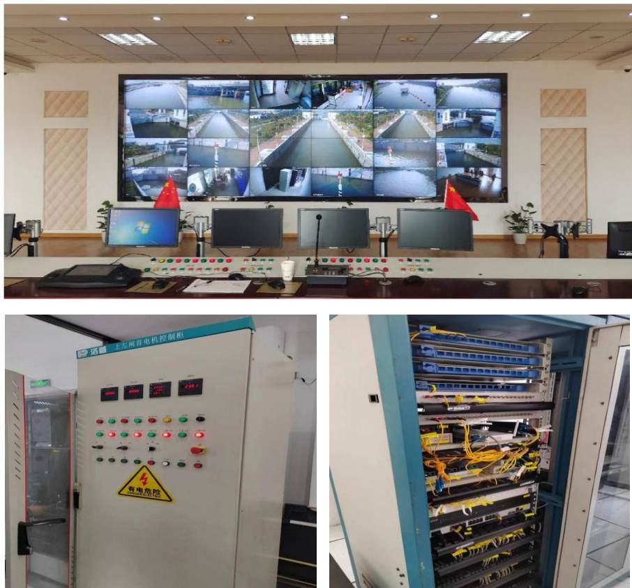
周山河船闸控制现状
